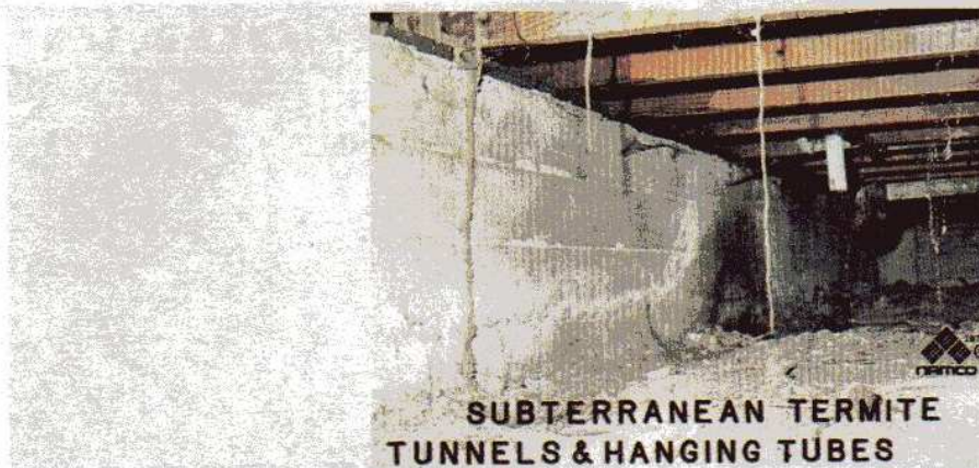
Figura 7-Hb. Galerías protegidas que cuelgan de las vigas del piso hacia el suelo (Van Waters and Rogers).
