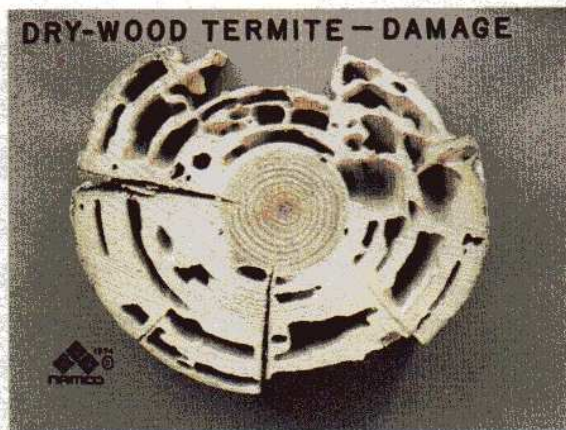
Figura 8-B. Daños típicos por termita de madera seca. Observe que las galerías son amplias y éstas, son perforadas por ellas, atravesando varios anillos anuales (Van Waters and Rogers).
