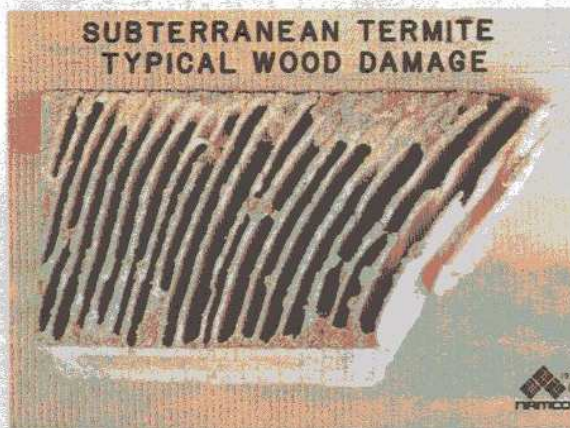
Figura 7-G. Ejemplo de un daño en la madera por termita subterránea. Observe que las capas delgadas de los anillos anuales han sido consumidas y las capas duras permanecen (Van Waters and Rogers).
